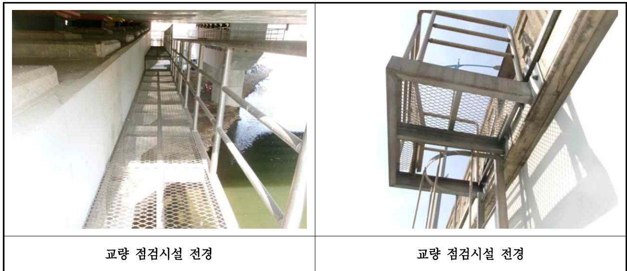
【사진 1.3.26】 교량 점검시설 손상현황
