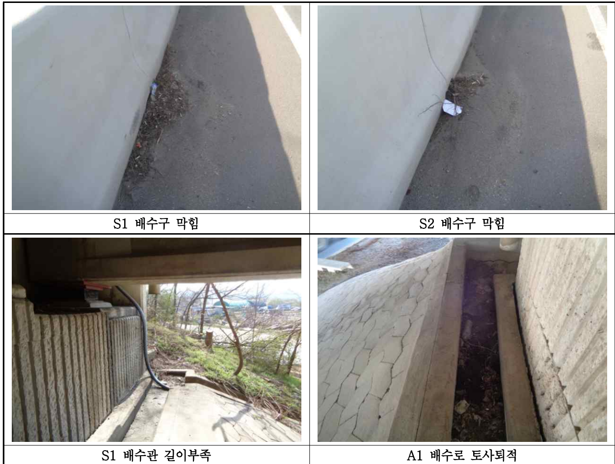
【사진 1.3.22】 배수시설 손상현황
